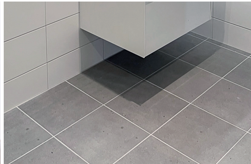
Kakel och klinker i duschrum och toaletter
