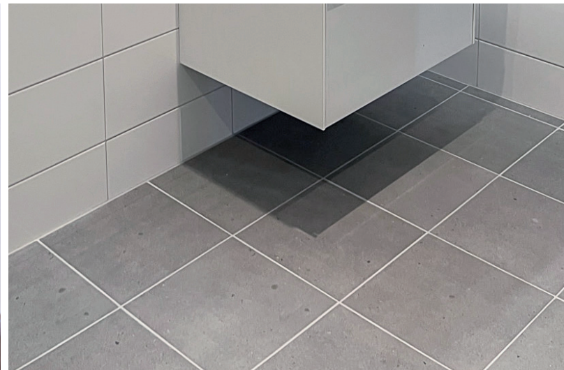
Kakel och klinker i duschrum och toaletter
